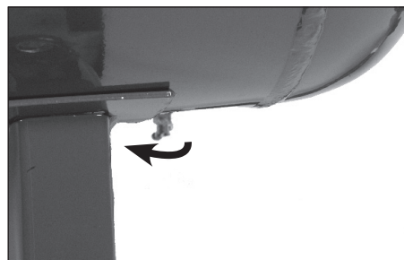
Figure 10 - Drain de réservoir manuel
